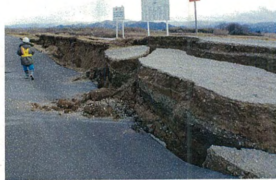
②右岸30.8k周辺被災状況を下流から望む
