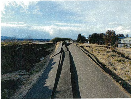
①枝野地区を上流から望む（復旧前）
