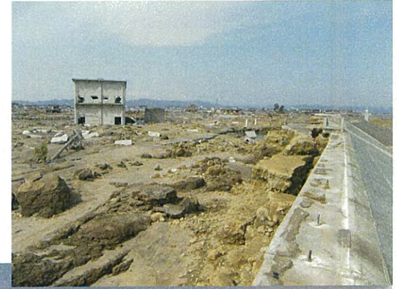
③荒浜地区堤防洗掘状況
