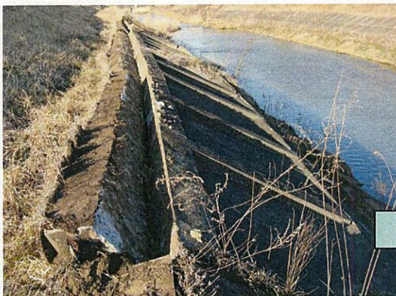
①東根川地区を上流から望む（復旧前）
