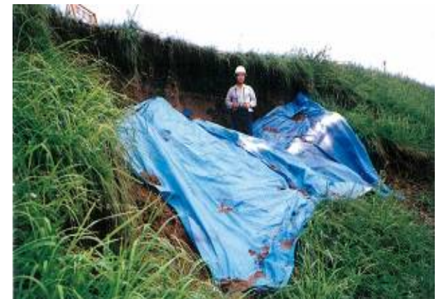
昭和61年8月洪水 法崩被害の状況 （岩沼市 押分地区）
