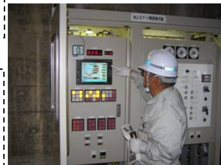
ゲート機側盤点検
