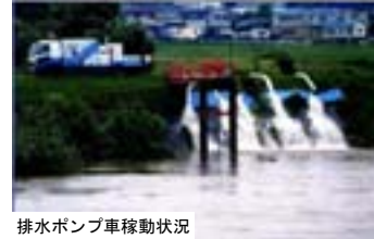
排水ポンプ車稼働状況
