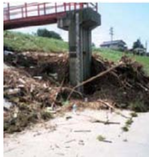
塵芥の堆積状況
