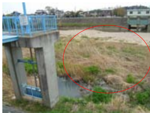
樋門の吐口に堆積した土砂
