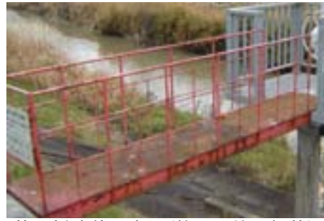
管理橋塗装の劣化(笹原川第6樋管)
