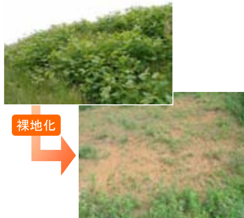
有害な植生の侵入による堤防の裸地化
