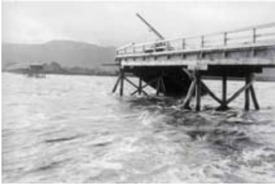
伊達崎橋の流失（福島県伊達市）
