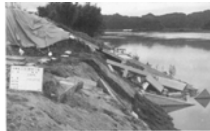
河岸崩壊の状況 昭和 61 年 8 月洪水 宮城県区間 20.0k 付近
