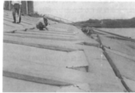
53年宮城県沖地震による護岸の被災状況 【宮城県岩沼市】
