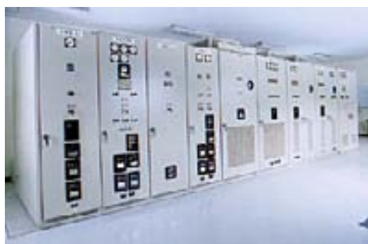
七ヶ宿ダム 受変電設備
