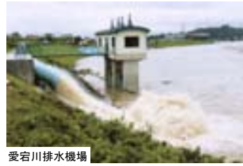
愛宕川排水機場
