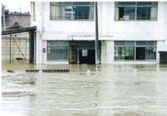
なめかわ 滑川公民館の浸水(福島県須賀川市)
