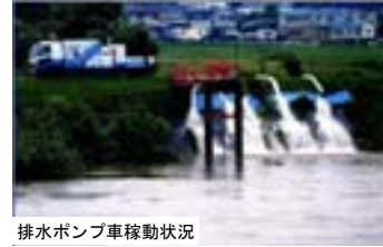
排水ポンプ車稼働状況
