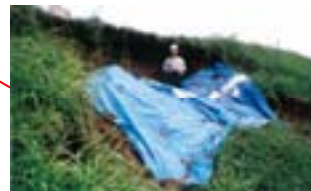
昭和61年洪水 法崩れ被害の状況
