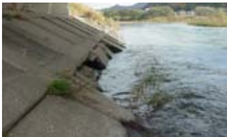
支川荒川 信夫橋護岸の崩壊の状況
