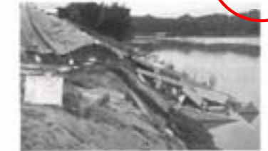
河岸崩壊の状況 昭和 61 年 8 月洪水 宮城県区間 20.0k 付近
