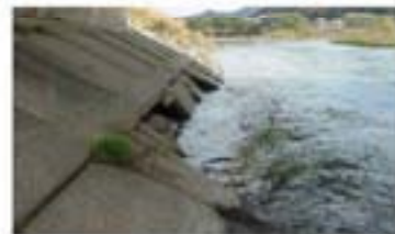
支川荒川 信夫橋護岸の崩壊の状況
