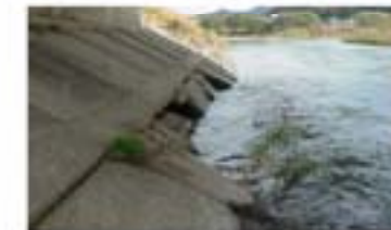
支川荒川 信夫橋護岸の崩壊の状況
