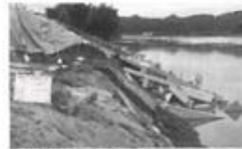
河岸崩壊の状況 昭和 61 年 8 月洪水 宮城県区間 20.0k 付近
