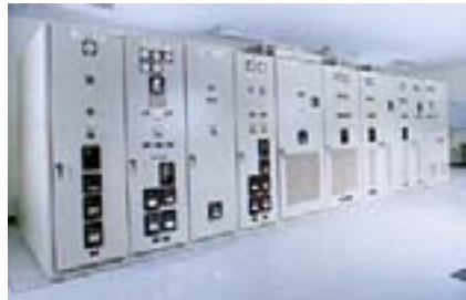
七ヶ宿ダム 受変電設備
