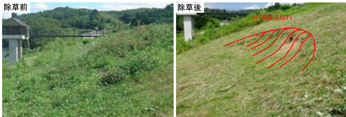
堤防除草により早期に発見された法崩れ
