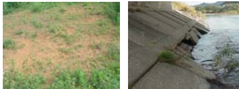
有害な植生の侵入による堤防の裸地化
