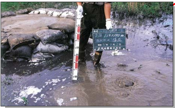
<昭和61年洪水> 漏水状況
