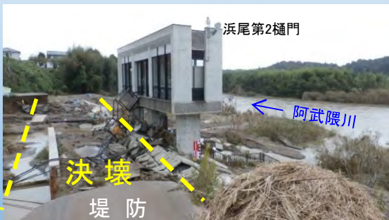
98.6k 左岸堤防決壊箇所(須賀川市)
