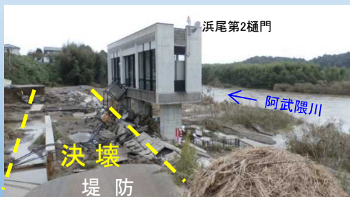
98.6k 左岸堤防決壊箇所(須賀川市)
