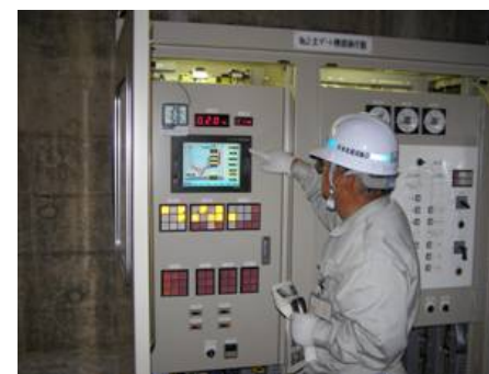
ゲート機側盤点検
