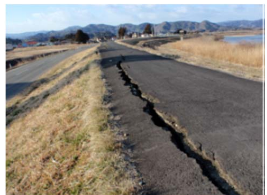
東北地方太平洋沖地震地震による堤防縦断亀裂 (丸森町小齊地先)
