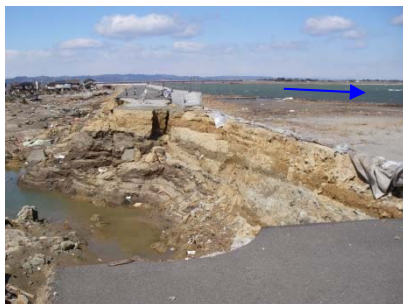
津波によって被災した河口部の堤防 (宮城県亘理町)
