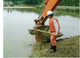
流木処理の状況
