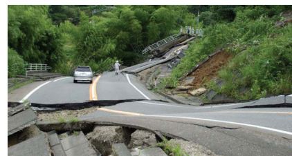
被災状況調査
