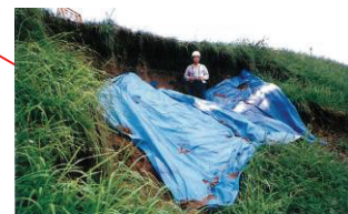
昭和61年洪水 法崩れ被害の状況
