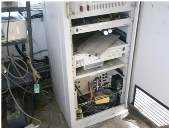
CCTV機側装置の被災状況
