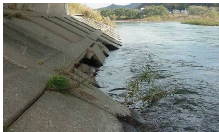
支川荒川 信夫橋護岸の崩壊の状況
