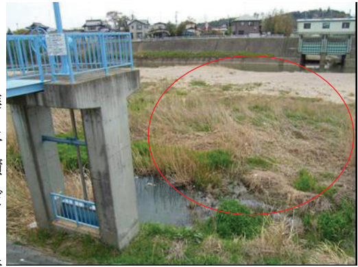
樋門の吐口に堆積した土砂
