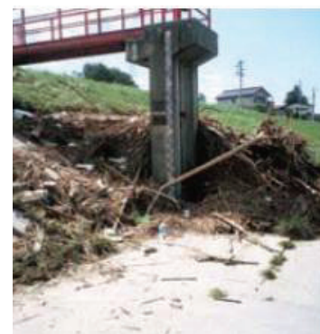
塵芥の堆積状況
