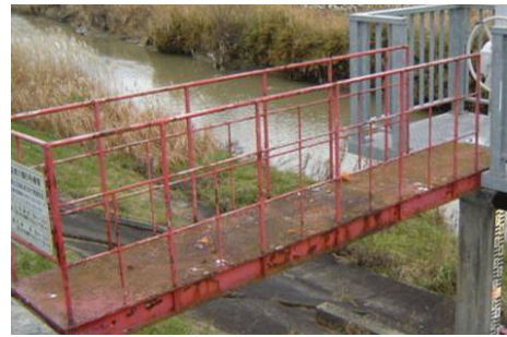
管理橋塗装の劣化(笹原川第6樋管)
