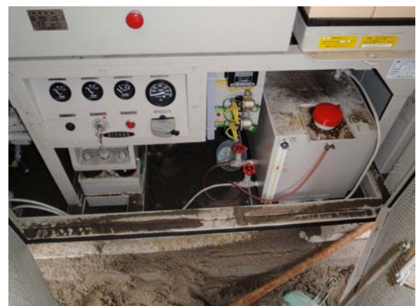
発電機盤の被災状況
