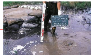
昭和61年洪水 漏水被害の状況
