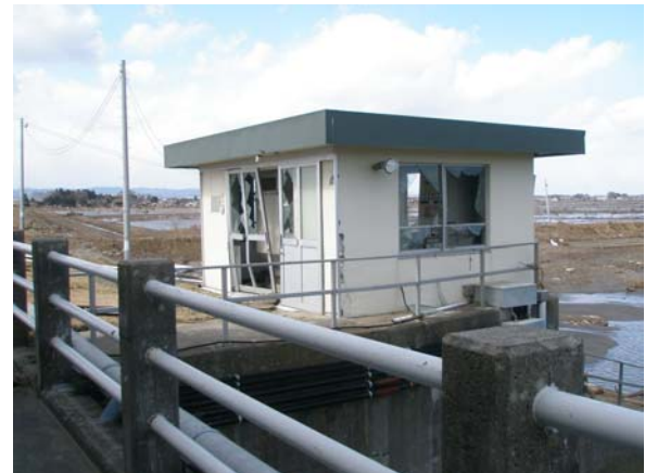
新浜水門局舎（被災後）
