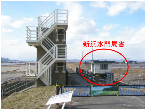
新浜水門（被災後）
