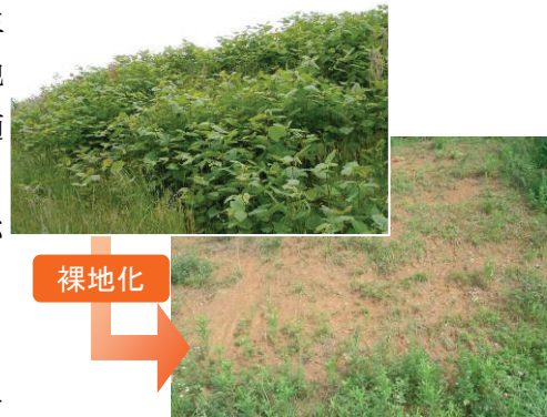
有害な植生の侵入による堤防の裸地化
