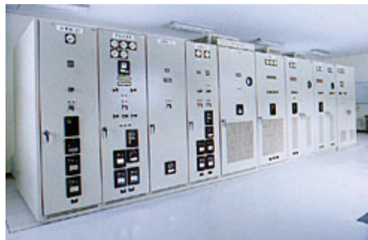
七ヶ宿ダム 受変電設備
