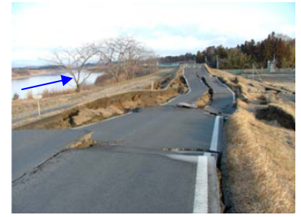
地震によって崩落した堤防 (宮城県角田市)
