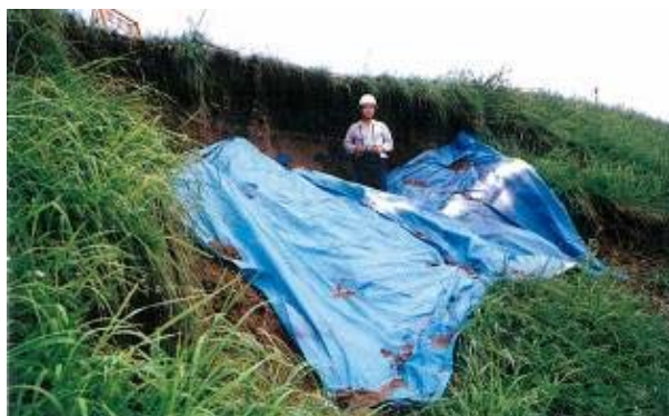
昭和 61 年 8 月洪水法崩被害の状況 (岩沼市 押分地区)
