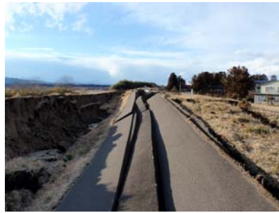
地震によって崩落した堤防 (宮城県角田市)
