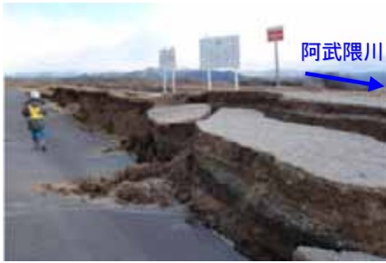
阿武隈川右岸31.0k付近 角田市枝野地先 地震により堤防沈下と天端の崩壊
