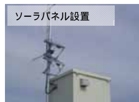
観測施設の電源二重化
