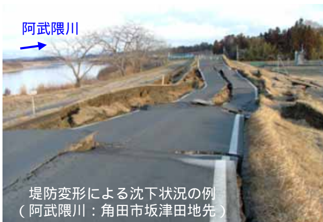
東北地方太平洋沖地震による堤防被災事例
