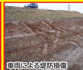
車両による堤防損傷
