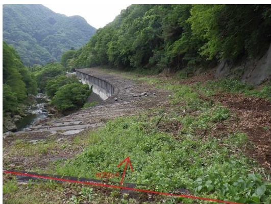
写真4-23 【損傷】上部工の漏水 （防水機能の劣化）
