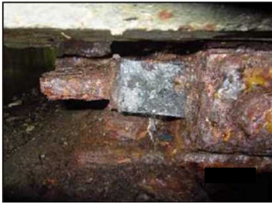
写真4-14 【損傷】 支承の腐食
