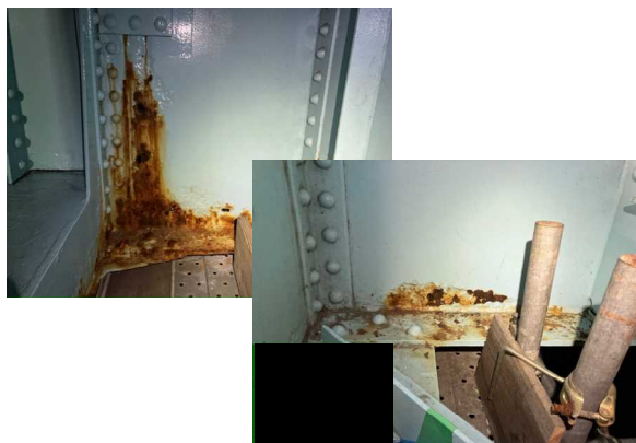
写真4-5 【損傷】主桁の腐食、欠損
