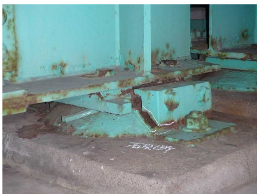
写真4-2 【損傷】支承本体の破断
