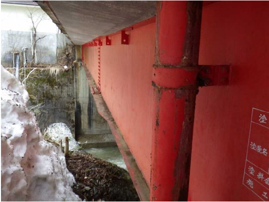
写真 4-8 【損傷】上部工の腐食
