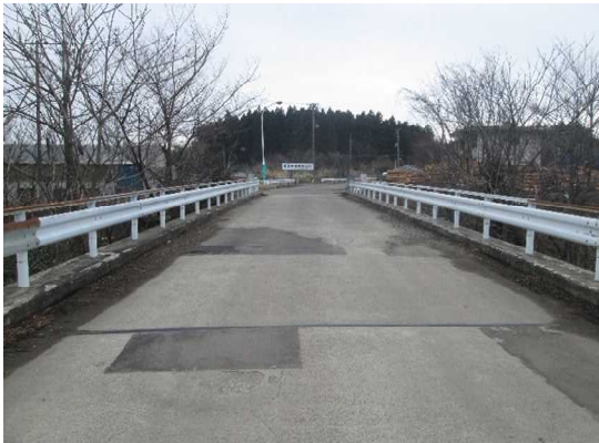
写真 4-11 【損傷】 高欄腐食、変形・地覆欠損 舗装割れ剥離
