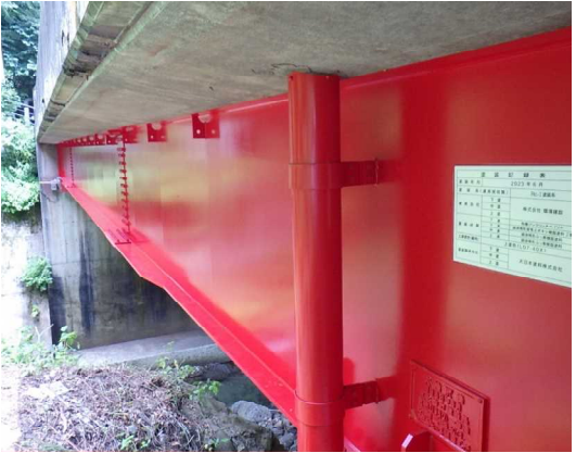
写真 4-9 【対策】塗装の塗替え
