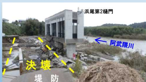
98.6k 左岸堤防決壊箇所(須賀川市)
