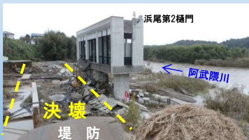
98.6k 左岸堤防決壊箇所(須賀川市)
