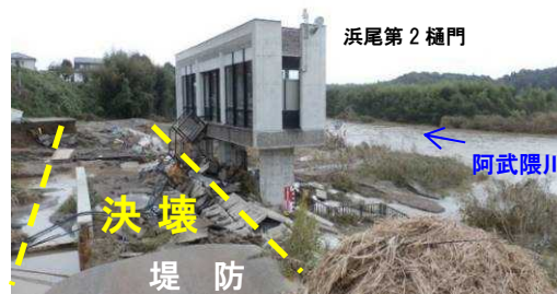
98.6k 左岸堤防決壊箇所(須賀川市)
