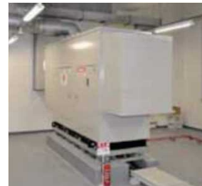
非常用発電設備のイメージ
