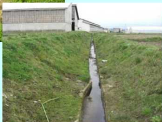
水路側壁の倒壊
