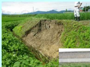
水路法面の崩壊
