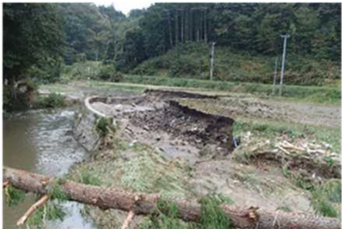
一級河川北須川の被災状況
