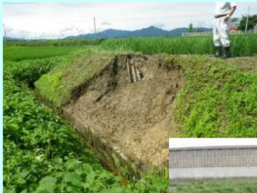
水路法面の崩壊
