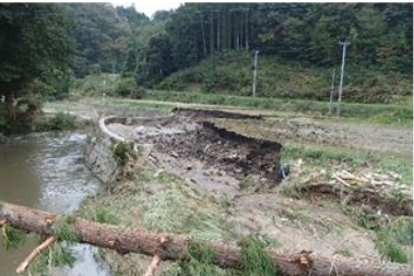
一級河川北須川の被災状況
