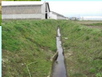
水路側壁の倒壊
