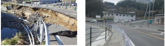
※ 台風19号国道288号線被害状況(被害状況:左 復旧状況:右)
