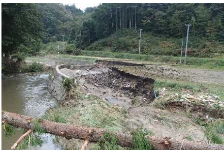
一級河川北須川の被災状況
