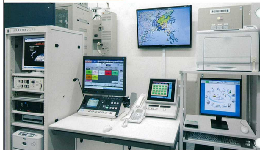
操作卓(防災センター)
