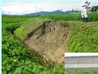
水路法面の崩壊
