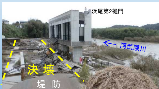
98.6k 左岸堤防決壊箇所(須賀川市)
