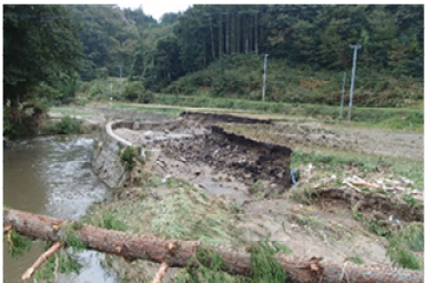
一級河川北須川の被災状況
