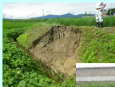
水路法面の崩壊
