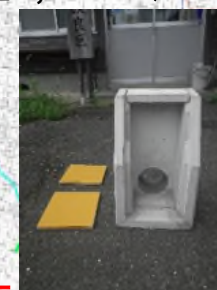
排水柵と堰板
