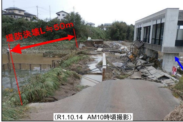
須賀川市浜尾地区(直轄区間)被災状況
