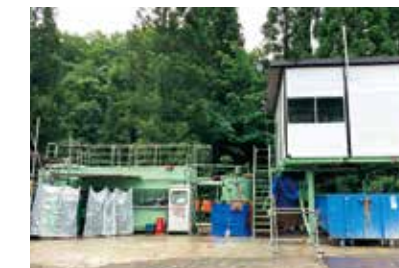
濁水処理設備
