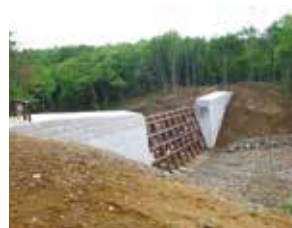
土石流発生前（H24年6月）
