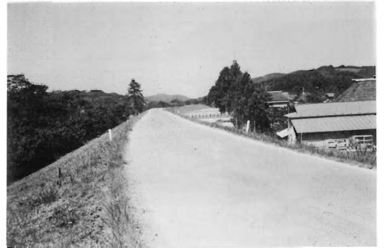
北上川下流堤防（宮城県登米郡東和町西郡地先）
