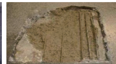
コンクリート床版の損傷（土砂化）
