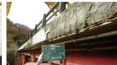
補修10年後の再劣化状況
