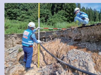
県道の被災状況調査
