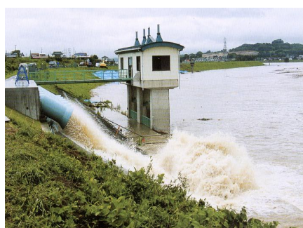
愛宕川排水機場(郡山市)
