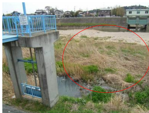
樋門の吐口に堆積した土砂
