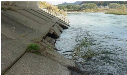
支川荒川 信夫橋護岸の崩壊の状況
