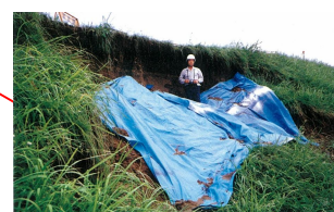
昭和61年洪水 法崩被害の状況
