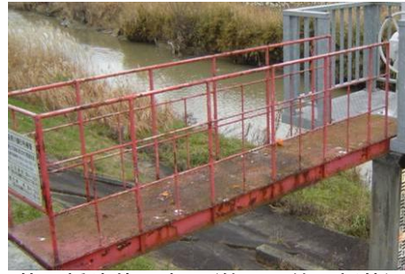
管理橋塗装の劣化(笹原川第6樋管)
