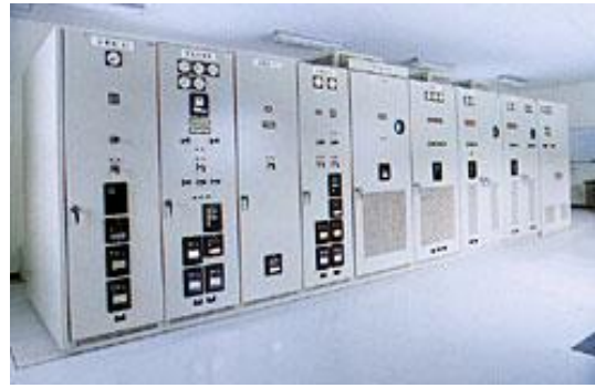
七ヶ宿ダム 受変電設備
