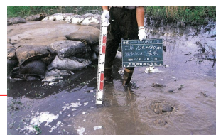
昭和61年洪水 漏水被害の状況
