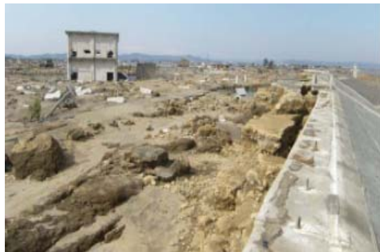
津波によって崩壊した堤防 (阿武隈川右岸-0.1k付近 (亘理町荒浜地先))
