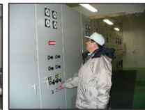
(ポンプの運転)
