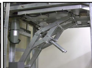
換気口浸水防止機
