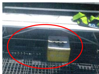
▲消火設備がない
