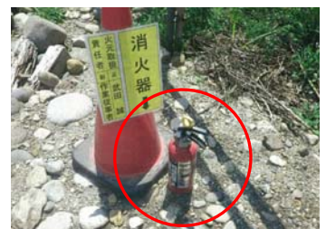
▲消火器が地べたに設置
