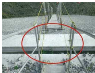
▲小段の水路が開口状態
