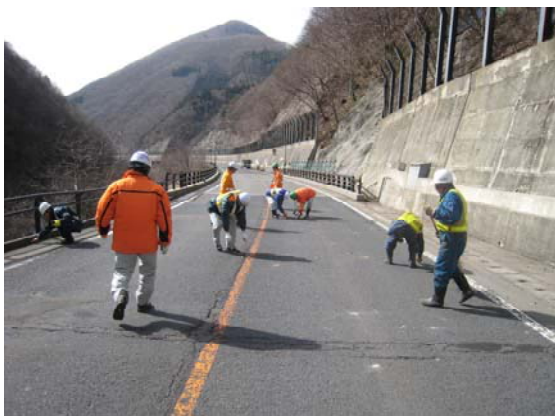
斜面から落とした石を片付けて交通解放します
