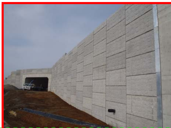
野黒沢高架橋北側の擁壁工一部が完成(野黒沢地区道路改良工事:新庄鈴木柴田組)
