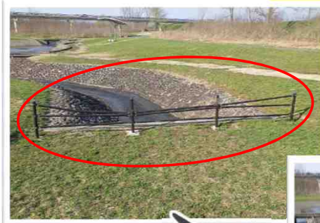
転落防止柵の損傷を確認
