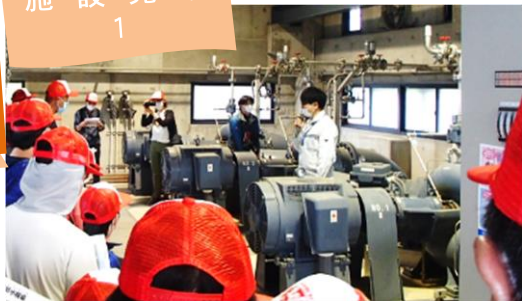
洪水時などに、田畑の水没を防ぐ施設 畔藤排水機場
