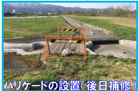
木橋の板の損傷 →
