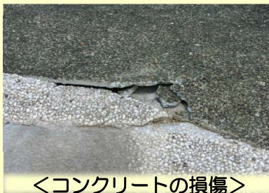
＜コンクリートの損傷＞
