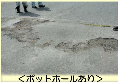
＜ポットホールあり＞
