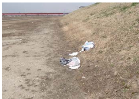
《2》最上川右岸 No.51+ 湊郷堰上流 法尻への家庭ゴミ投棄
