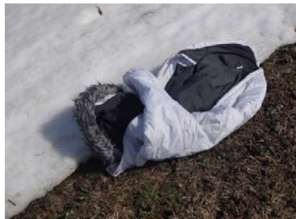
《34》最上川左岸No.83+ 置賜橋下流川裏法面 衣類の投棄
