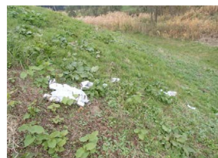
《20》天王川左岸No.2+ 川表法面 空き缶の不法投棄
