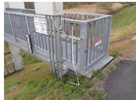
《18》最上川右岸No.77 高畠樋管管理橋 損壊したスケールの投棄
