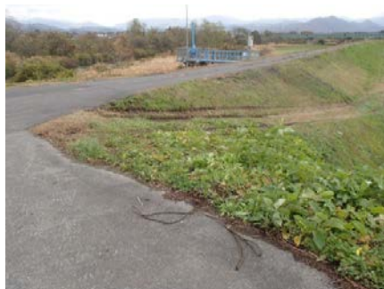
《17》鬼面川右岸No.1- 鬼面川合流点天端 損傷したワイヤーの投棄
