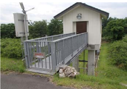
《10》最上川右岸No.77 高畠樋管管理橋脇 農業用廃ビニールの投棄
