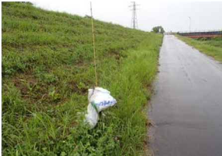
《11》誕生川No.12+ 誕生川橋下流 河道内への農業用廃ビニールの飛来
