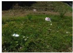
右岸 No.69+90 さくら大橋下流 表法面 家庭ゴミの散乱 (弁当容器・空き缶・ビニール類) 9月15日確認
