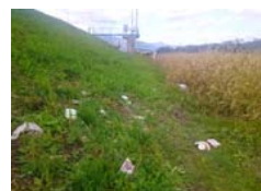
左岸 No.76+90 向野樋管 下流側 表法面 家庭ゴミ(弁当容器・ビニール類) 10月14日確認
