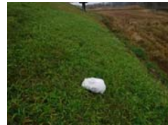
左岸 No.77 向野樋管 上流側 表法面 家庭ゴミの投棄 (ビニール袋・食品トレイ) 11月2日確認
