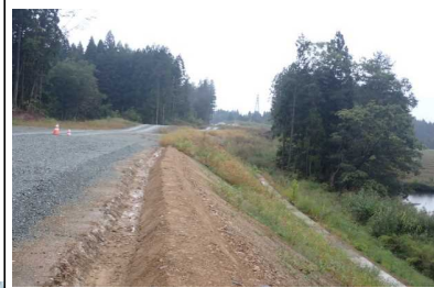
十日町西山中地区(尾花沢方向)
