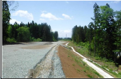
十日町西山中地区(尾花沢方向)
